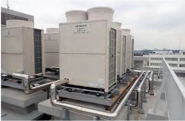
【写真1】高効率空調機（高COP）（西9号館）
