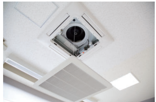
写真2 電動昇降式の室内パネル
