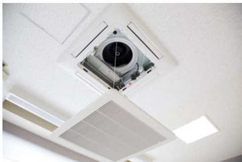
写真2 電動昇降式の室内パネル
