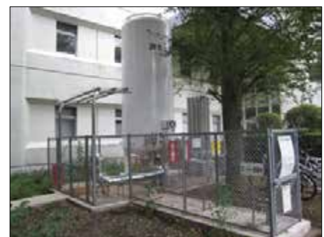
西地区に新設した液体窒素供給所
